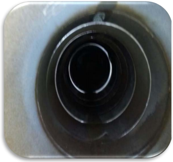
방청 후 배관 내부
